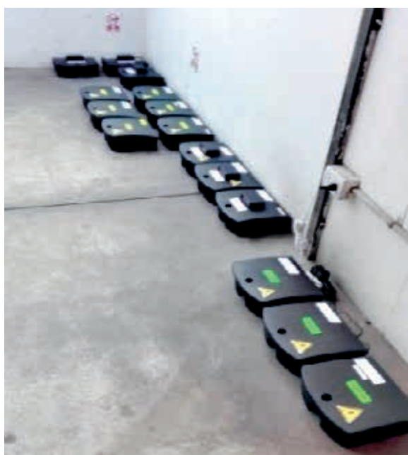
Figura 6. Prueba en instalaciones de Control S. A. C. (Azotea). Fuente: Elaboración propia.
